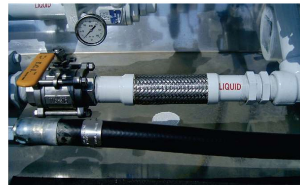
Рисунок №4. гибкий шланг в выходном отверстии
